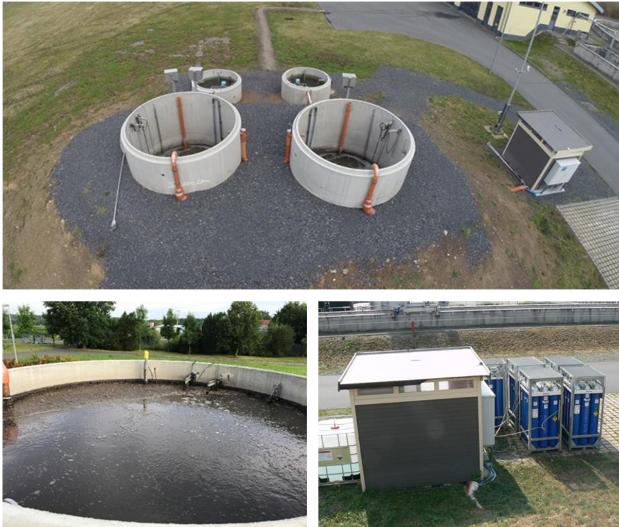
Abb. 3-21 – Versuchskläranlage zur vergleichenden Untersuchung der Sauerstoffversorgung biologischer Behandlungsstufen von Kläranlagen mit Luft- und Elektrolysesauerstoff am Standort Sonneberg-Heubisch der Wasserwerke im Landkreis Sonneberg.
